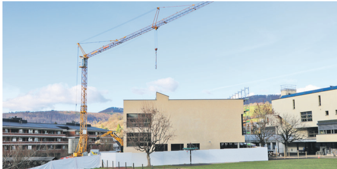
In den kommenden Monaten wird die Mehrzweckhalle Bützenen auf den neuesten Stand gebracht. Bild zvg
